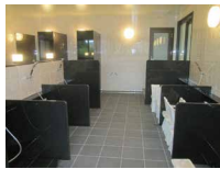
ゴルフ場の浴室の改修工事をさせていただきました。トイレや給湯室等の水回りの工事もお任せください。
