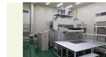
クリーンルーム内に整備したプレス機です。
